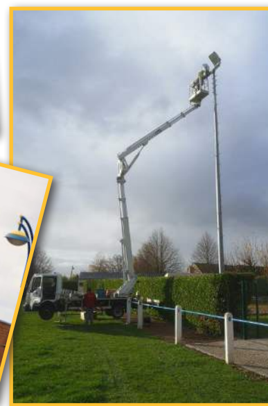
Éclairage LEDs au stade
